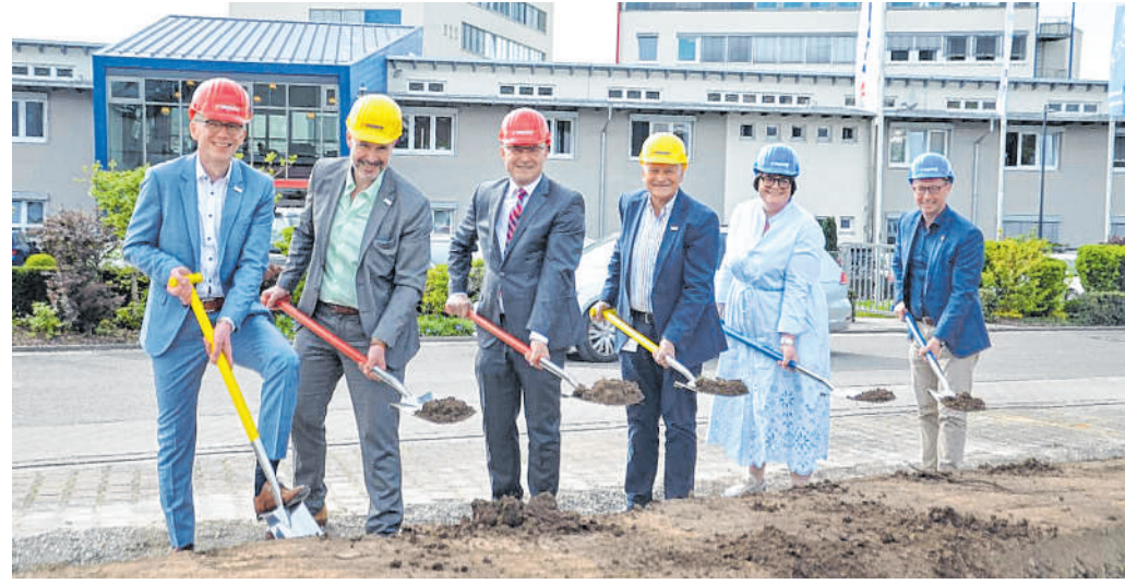
Gemeinsamer symbolischer erster Spatenstich zum neuen MPDV-Gebäude: Von links, Jürgen Petzel und Thorsten Strebler, beide Geschäftsführer bei MPDV, Landrat Dr. Achim Brötel, Prof. Dr.-Ing. Jürgen Kletti, Firmengründer und Geschäftsführer von MPDV, Nathalie Kletti, Geschäftsführerin MPDV und Julian Stipp, Oberbürgermeister Mosbach
