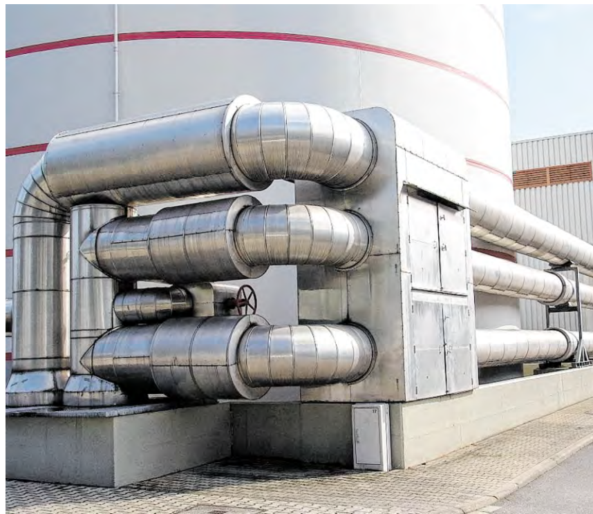
Fernwärme-Hauptzuleitung von Mannheim nach Heidelberg
