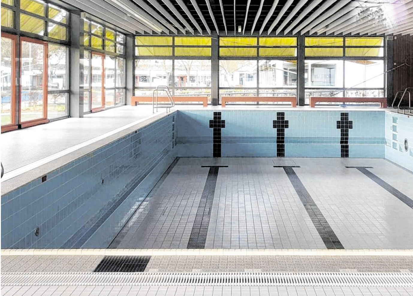
Der Hubboden im Schwetzinger Lehrschwimmbad wird gewartet.
