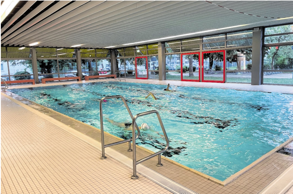
Die Nordstadtschwimmhalle muss saniert werden. 2025 wurde eine Reparatur am Hubboden vorgenommen.
