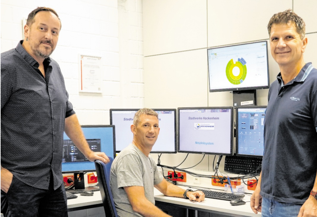
Werkleiter Sven Sölter (v. l.), Christian Klefenz (Elektromeister Netz) und Alexander Lecueva Deutsch (EDV der Stadtwerke) in der Hockheimer „Netzleitwarte“ im E-Werk.
