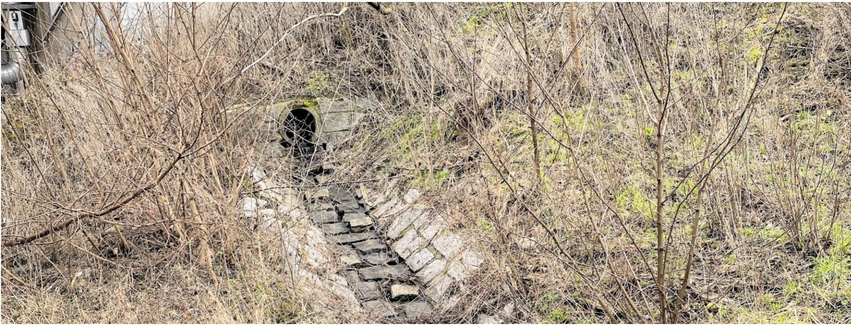
Es ist eine schwarze Brühe, die nach Regen vom Brückenbauwerk in Richtung Kothlachgraben fließt.
