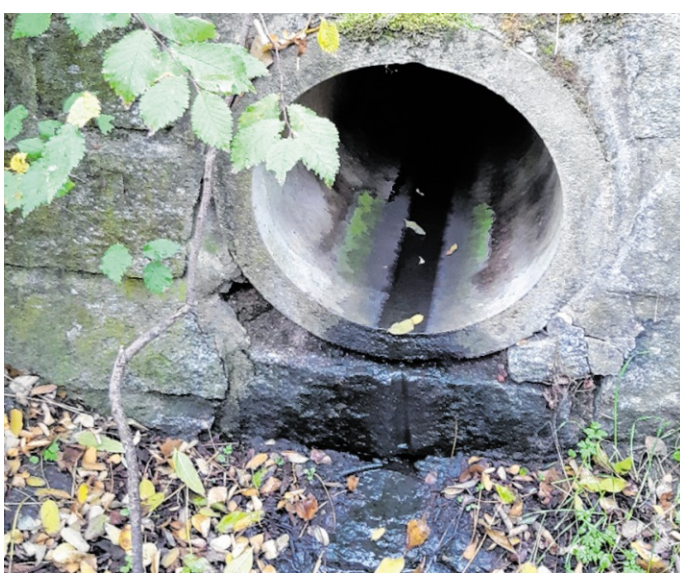
Das Abwasser ist vom Abrieb deutlich sichtbar gefärbt. BILD: UWE HEIDENREICH
