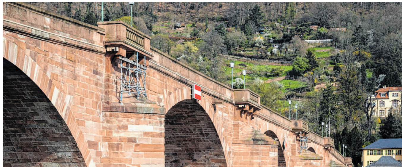
Generalsanierung unumgänglich: Derzeit werden vier Balkone mit Gerüsten abgestützt.
