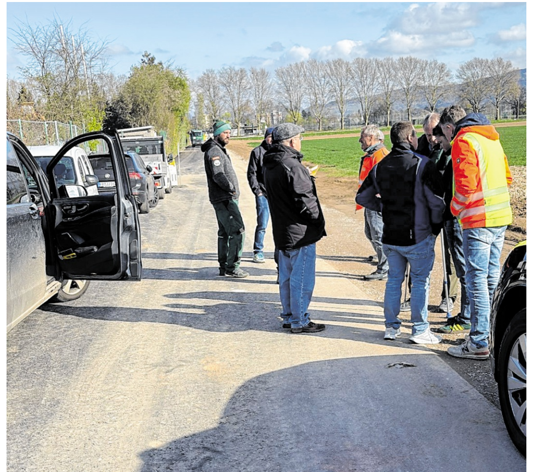
Punktlandung bei der Bauabnahme: Die Sanierung des Sulzbacher Dammwegs wurde offiziell abgenommen – Ortsvorsteher Eberhardt zeigt sich zufrieden.
