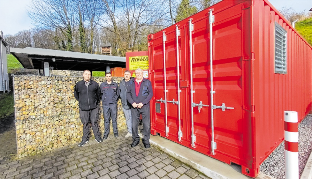
An vier Feuerwehrstandorten wurden Notstromaggregate installiert. Sie sichern nicht nur die Einsatzfähigkeit der Feuerwehr, sondern dienen im Ernstfall auch als Anlaufstellen für Bürger. BILD: STADT WEINHEIM
