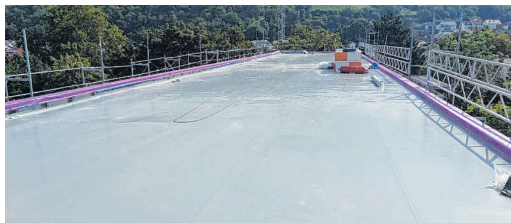
Dach an mehreren Stellen undicht: Mit dem Ende der Sommerferien, also Anfang September, sollen die Baumaßnahmen abgeschlossen sein. BILD: STADT HEMSBACH
