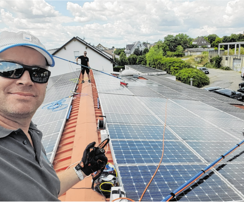
Photovoltaikanlagen sollten regelmäßig gründlich und professionell gereinigt werden. Unter anderem darauf spezialisiert hat sich die Firma RNC Ebert GmbH in Sinsheim.
