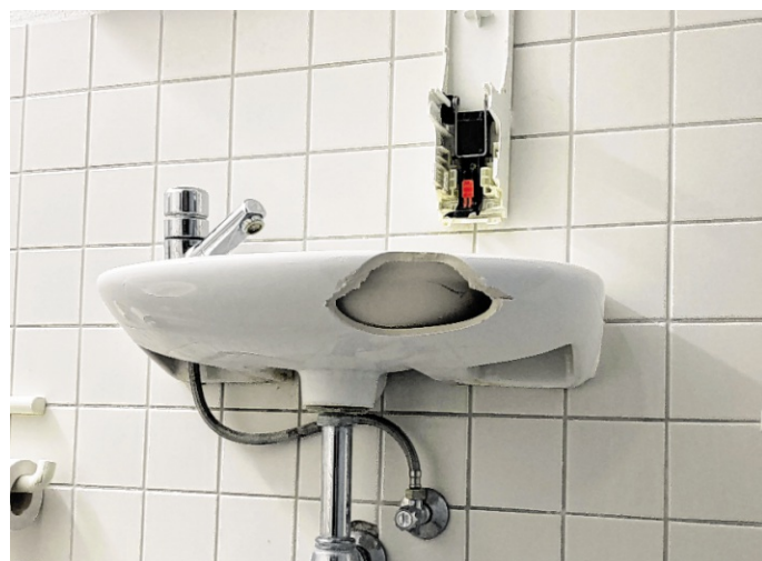
In der Sporthalle am Stadion wurden mehrere Umkleieräume erheblich beschädigt.
